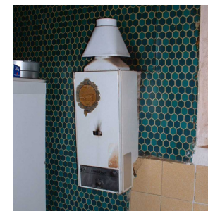
Absence de dispositif d'évacuation des gaz brûlés
