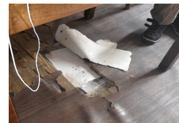
Revêtement de sol dégradé
