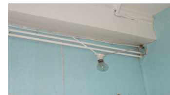
Eclairage insuffisant et dangereux
